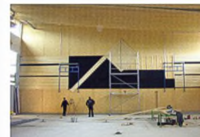
Schallschutz an der Westinnenseite der Halle
