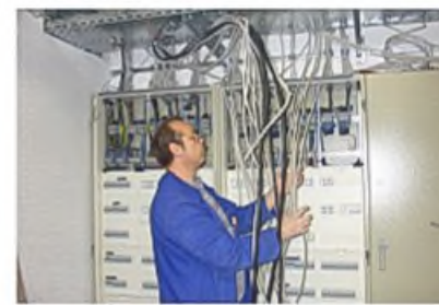
jede Menge Kabel kommen in der Schaltzentrale im Technikraum zusammen
