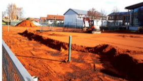
Nachdem die Linien entfernt worden sind, kann mit dem Abschieben der bisherigen roten Sandschicht mit Laderaue und Bagger begonnen werden
