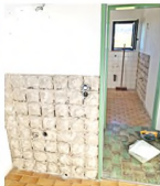
die Fliesen in den WC sind abgeschlagen
